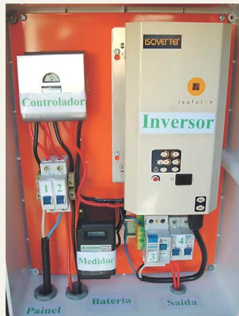
Foto 20 – Detalle de um sistema solar residencial
