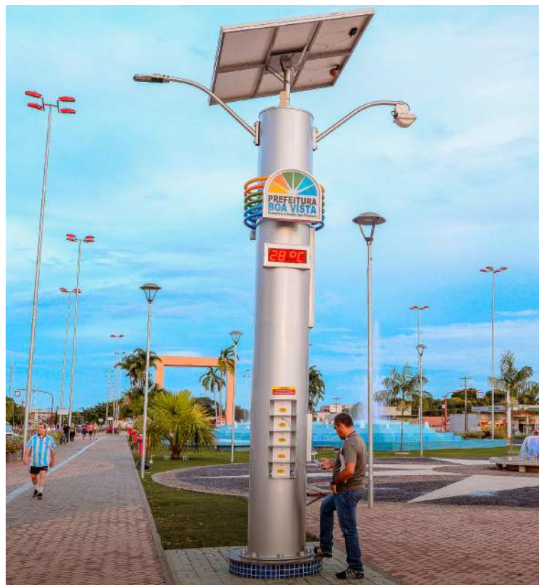
Iluminação pública com energia solar fotovoltaica.
