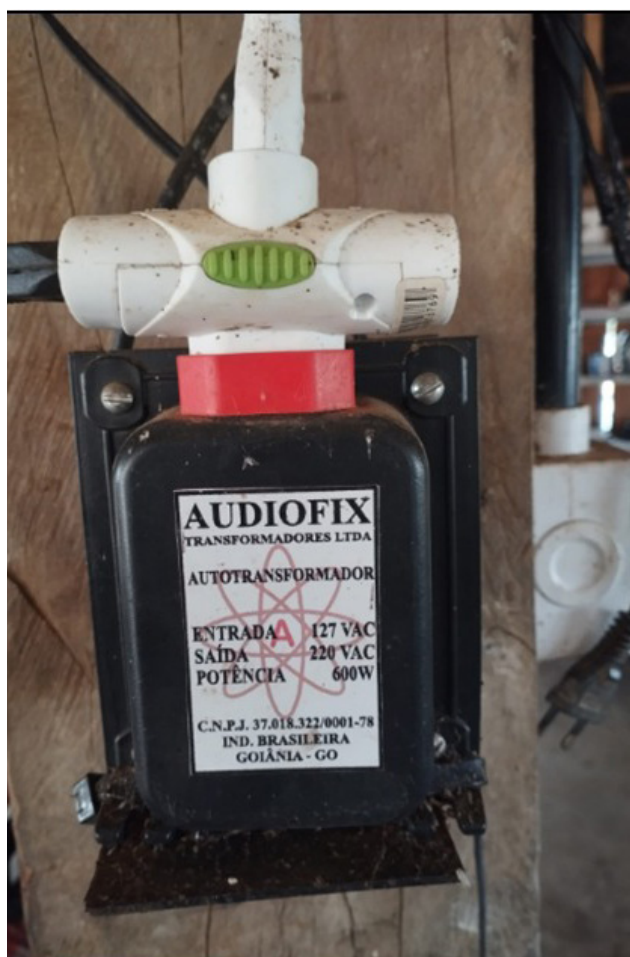
Figura 16. Transformador 127/220 V instalado nas residências de madeira e palha da Aldeia Khikhatxi. FOTO: Vinícius Oliveira/IEMA
